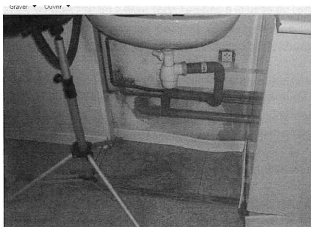
Dégât des eaux local salle coiffure
